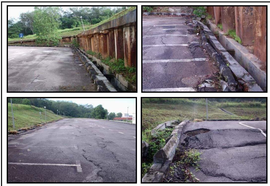
Rajah 1.2 Tempat letak kereta di Bangunan Tambahan FKM ( gambar diambil pada April 2006 ).
