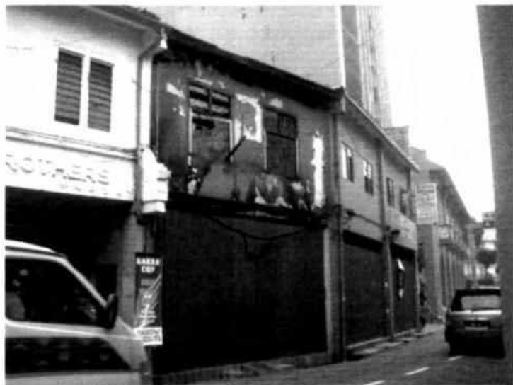
Gf 1.2 : Rumah Kedai Yang Terbakar Yang Dibiarkan Begitu Sahaja (Jalan Laksamana), 2006
