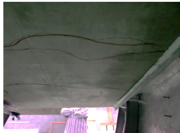
(d) Transverse cracks underneath slab M12 specimen
