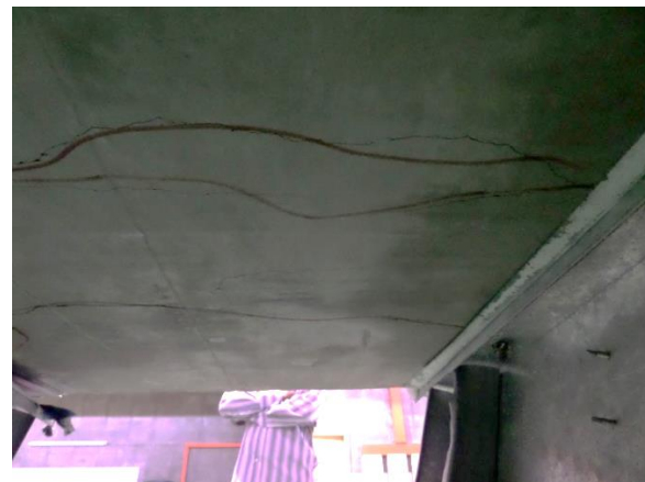
(d) Transverse cracks underneath slab M12 specimen
