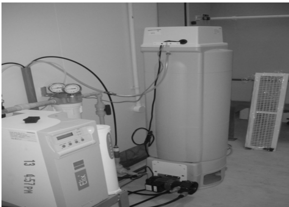
Figure 10. DI water system.
