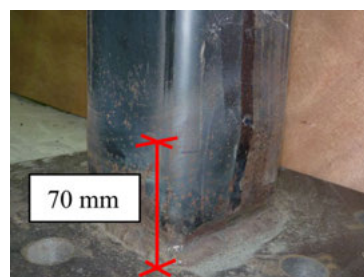
(d) Deformation of RuPCHS-20 (right face)
